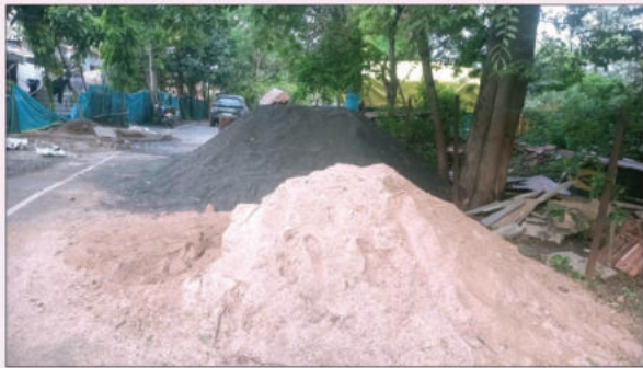
मौके पर अवैध निर्माण हेतु पड़ी निर्माण सामग्री
